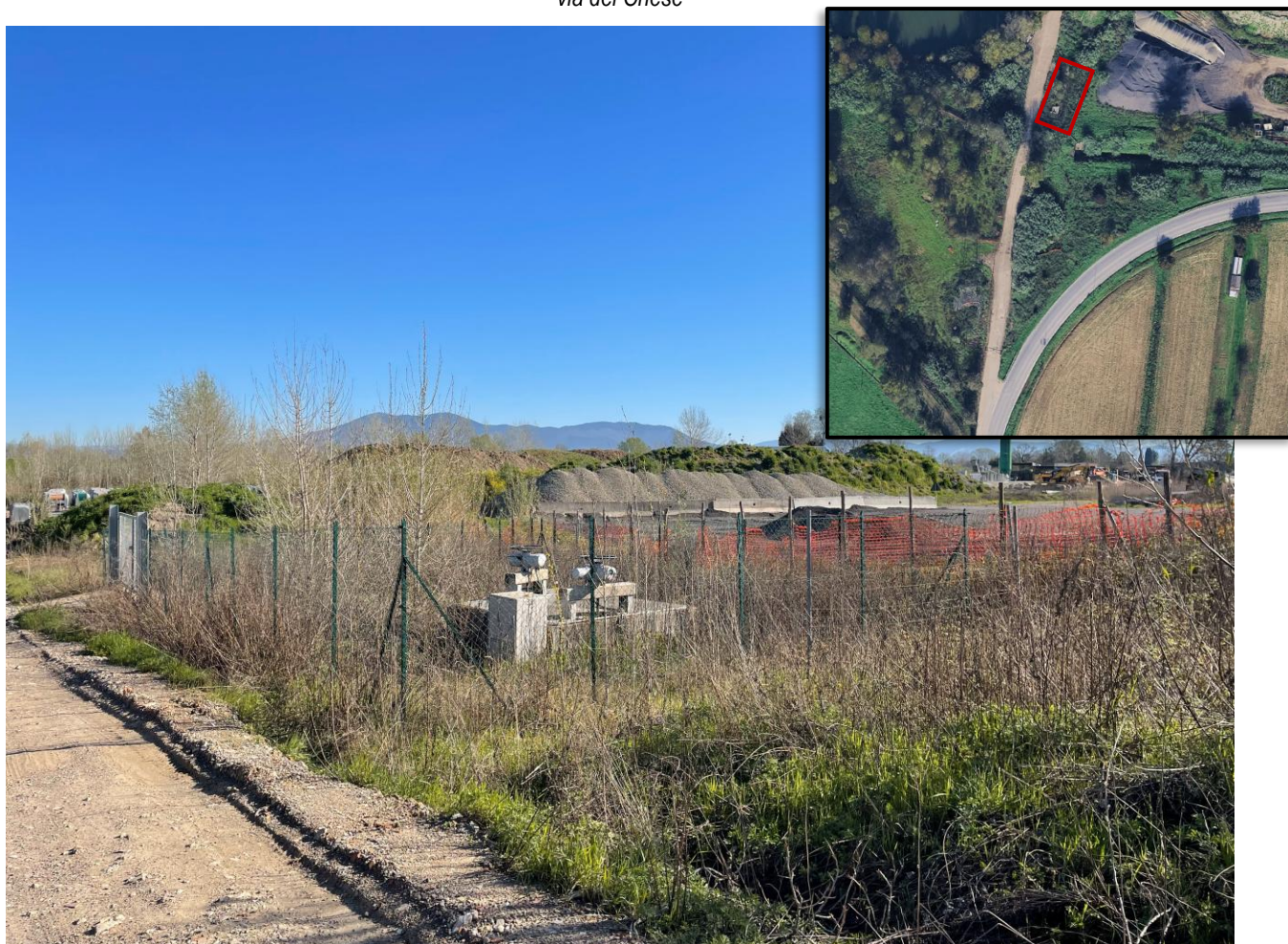
Figura 3-3: Manufatto di controllo del sistema fognario in soprasuolo all'interno dell'area recintata lungo via del Chese
